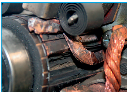
Povrch komutátoru je sklovitý. Ohnuté lamely komutátoru.
