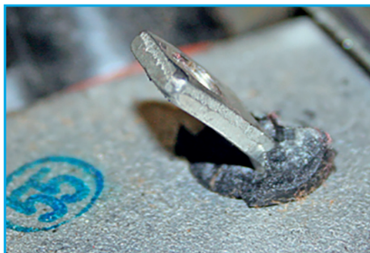
Rozpojení kontaktu může způsobit zkrat na kostru.
