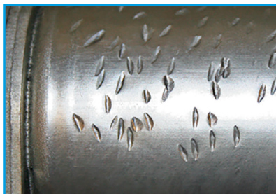
Το κάλυμμα του μαγνητοδιακόπτη έχει επανειλημμένα χτυπηθεί με σφυρί ή με κάποιο άλλο ξένο αντικείμενο.
