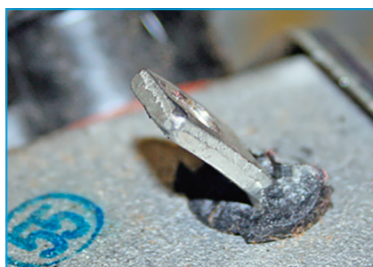
A házra szerelt testérintkező tönkrement.
