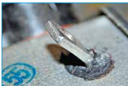
Deteriorarea bornei poate conduce la contactul de masă cu carcasa.
