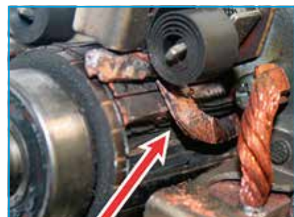
Bara colectorului s-a separat, s-a ridicat și s-a îndoit (deformat).
