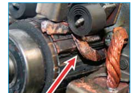
Pręt segmentu komutatora został oddzielony, podniósł się i wygiął (odkształcił).
