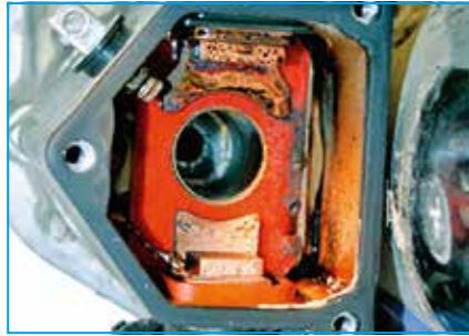
Stopione powłoki przewodów i przebarwienie obudowy. Zapach spalinowy.
