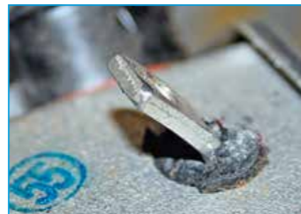
Uszkodzenie przyłącza może powodować dotknięcie ziemi obudową.
